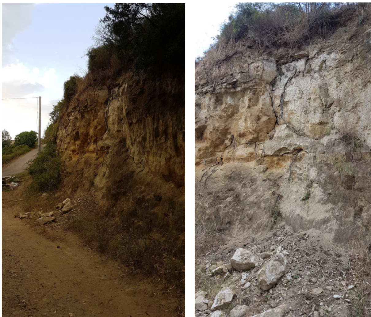
Figure 24: particolare dell'ammasso roccioso in franamento
